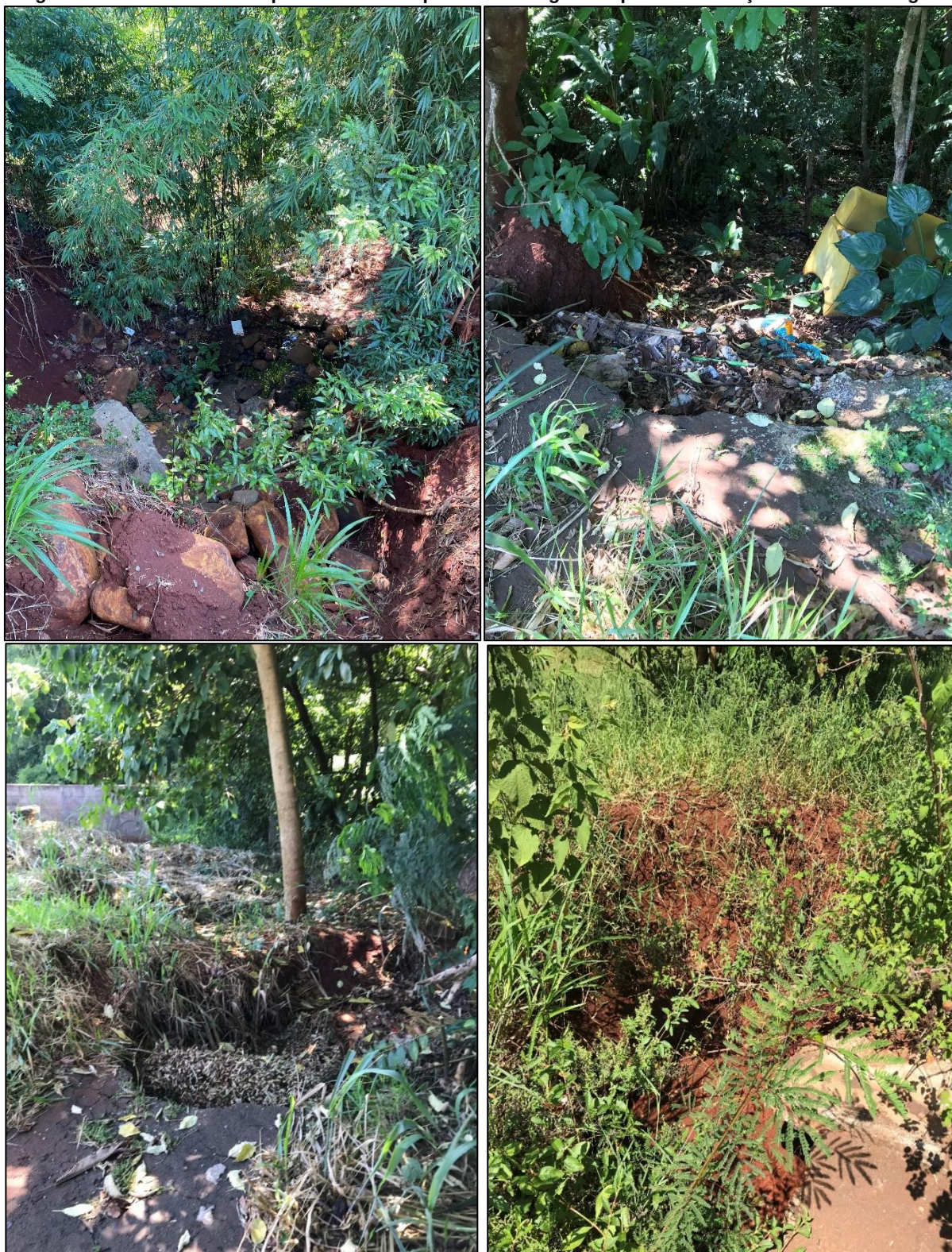
Figura 66 - Erosão causada por falta de dissipador de energia nos pontos de lançamento de drenagem
