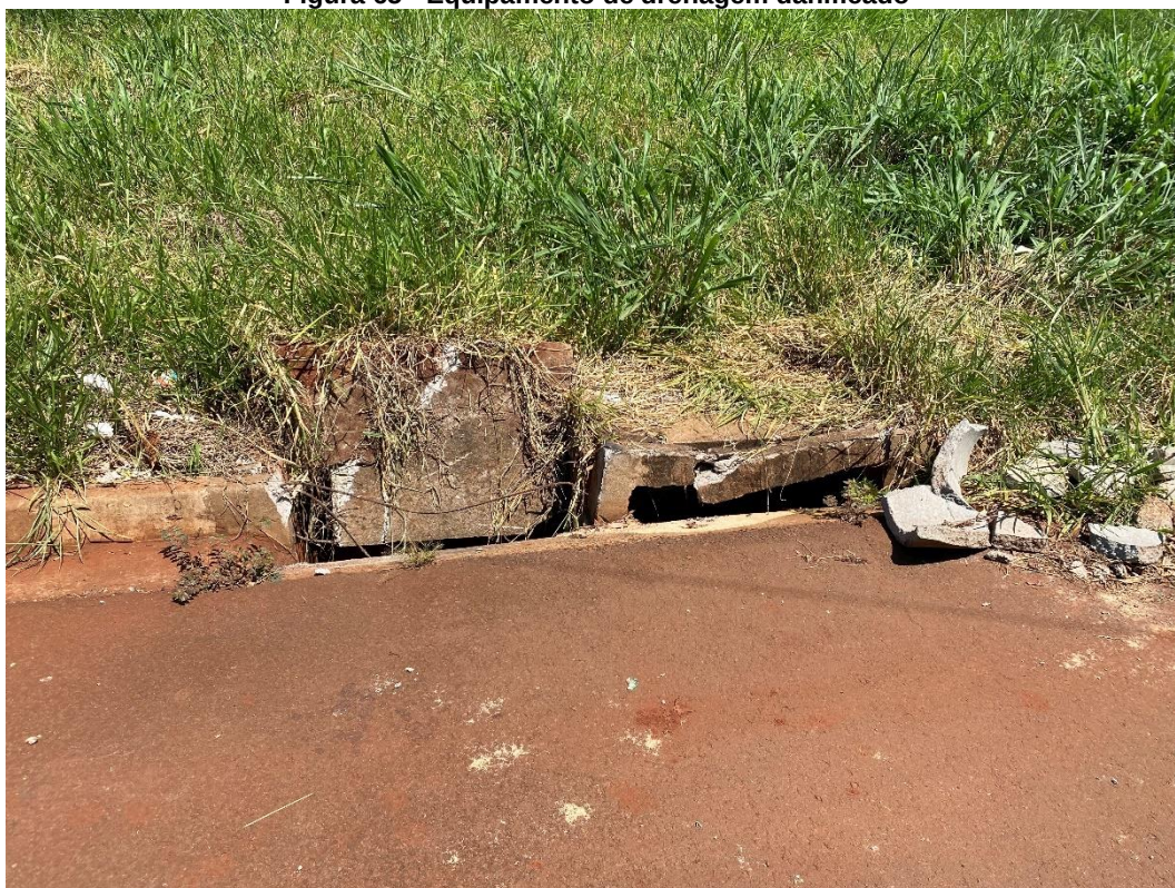
Figura 65 - Equipamento de drenagem danificado
