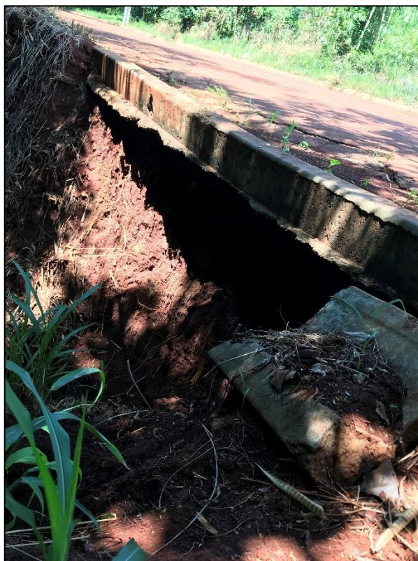
Figura 63 - erosão de leito e subleito causando desmoronamento do meio fio
