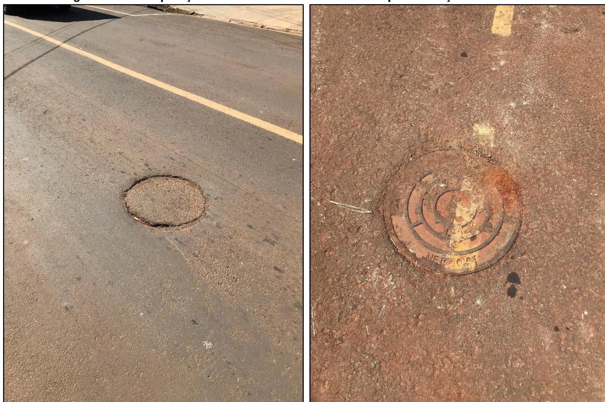
Figura 64 - sobreposição de material asfáltico sobre tampas de Poços de Visita – PVs
