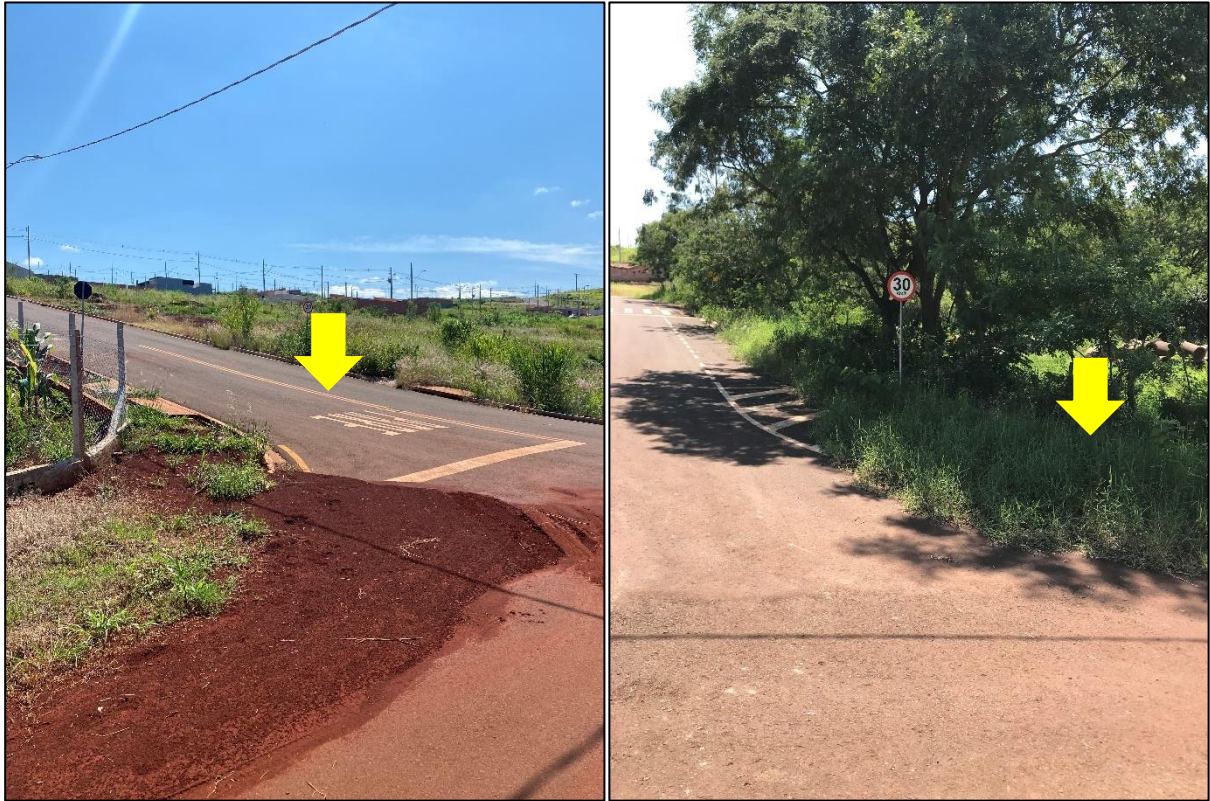
Figura 67 - carreamento de material e crescimento de vegetação na sarjeta do meio fio
