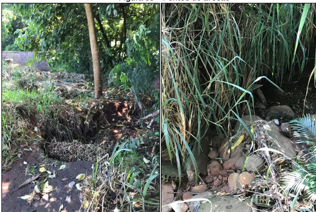
Figura 58 – Pontos de Erosão
