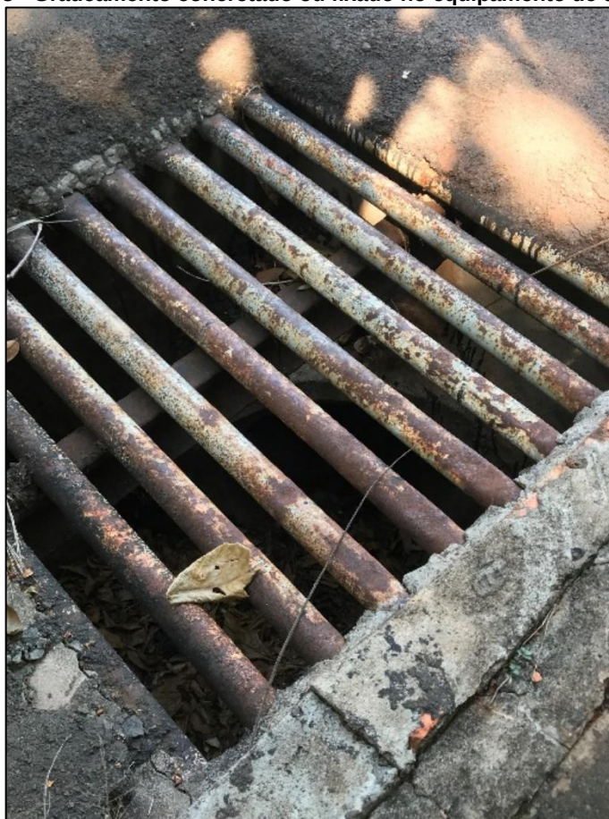
Figura 68 - Gradeamento concretado ou fixado no equipamento de drenagem
