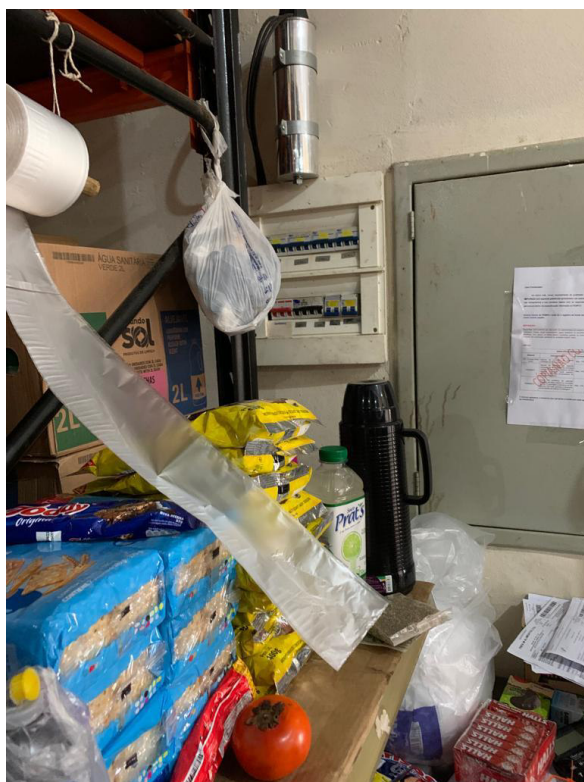
Imagem 91: Quadro de distribuição de energia
