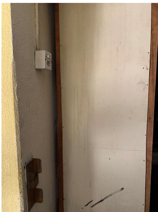
Imagem 31: Interruptor/Ponto de tomada (Depósito para materiais)
