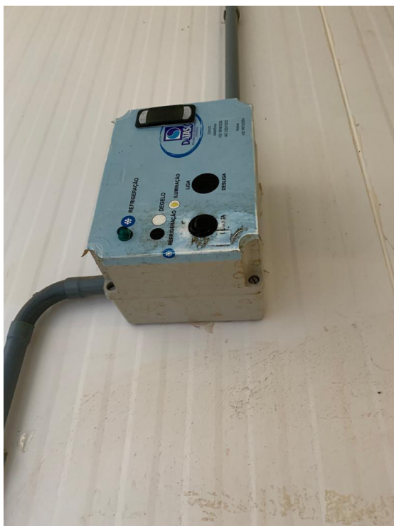
Imagem 73: Dispositivo de controle de refrigeração
