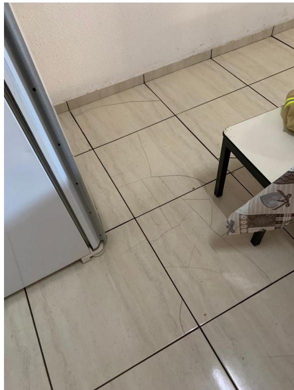
Imagem 106: Piso cerâmico danificado (Refeitório)
