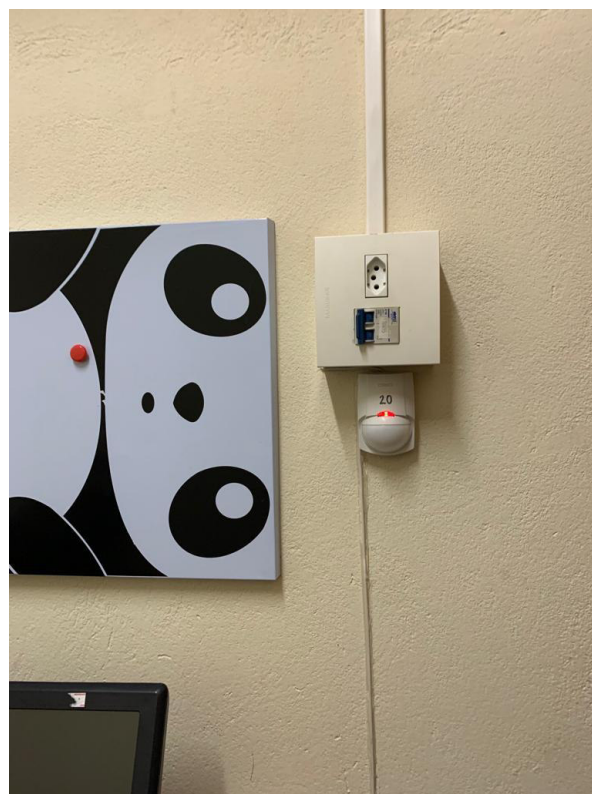
Imagem 90: Disjuntor de aparelho de ar condicionado
