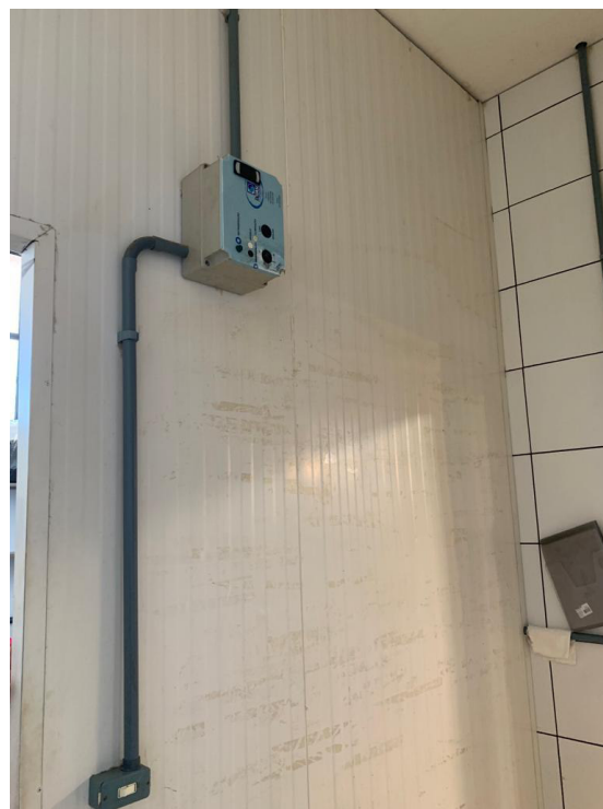
Imagem 74: Dispositivo de controle de refrigeração
