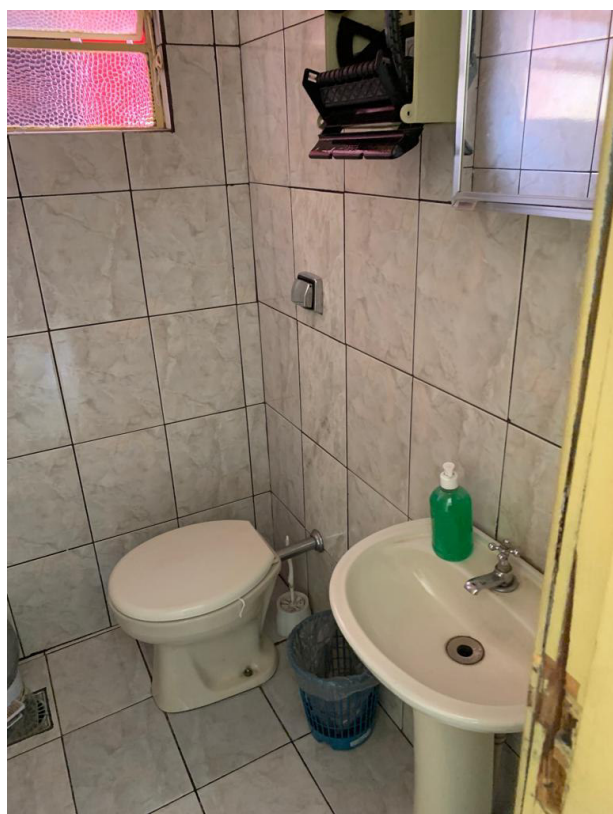
Imagem 127: Banheiro (Recepção) - porta danificada (s/maçaneta e fechadura)
