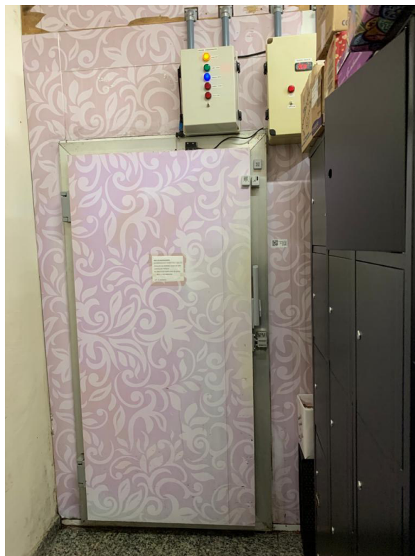
Imagem 70: Casa de máquinas das prateleiras de congelados
