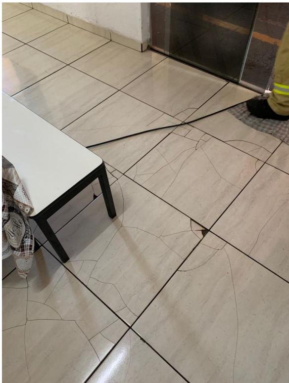
Imagem 105: Piso cerâmico danificado (Refeitório)
