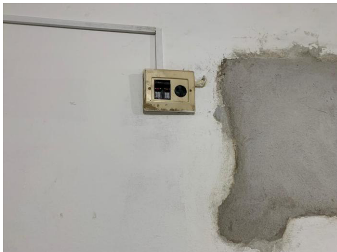
Imagem 153: Parede sem acabamento final (massa corrida e pintura)
