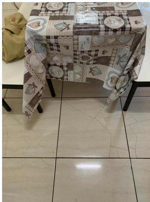
Imagem 104: Piso cerâmico danificado (Refeitório)
