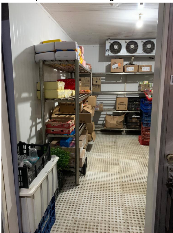
Imagem 72: Porta de acesso à câmara fria de refrigerados
