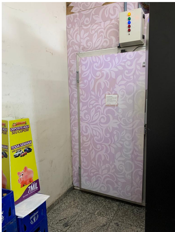
Imagem 69: Casa de máquinas das prateleiras de congelados
